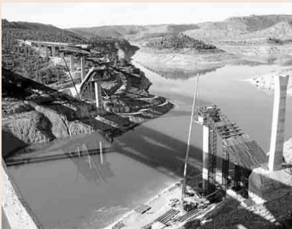
Construcción del viaducto del Embalse de Contreras, situado entre las provincias de Valencia y Cuenca.
